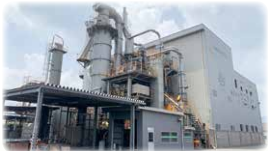
モニターで遠隔監視・集中制御されている焼却施設
